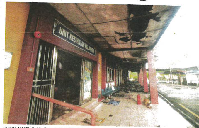
KEADAAN Klinik Kesihatan Parit Baru yang terbakar pada 12 September lalu.
